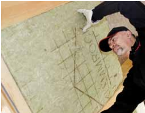
Trotz hoher Dämmdicke und schwankenden Sparrenabständen konnte die Steinwolle-Dämmung mit wenigen Handgriffen zuverlässig zwischen die Sparren geklemmt werden.
