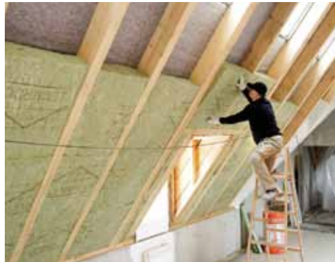
In dem mit einem hohen Wärmeschutz ausgestatteten Dachgeschoss arbeiten heute die Mitarbeiter der Hochbau- und Planungsabteilung der Stadt Gladbeck.
