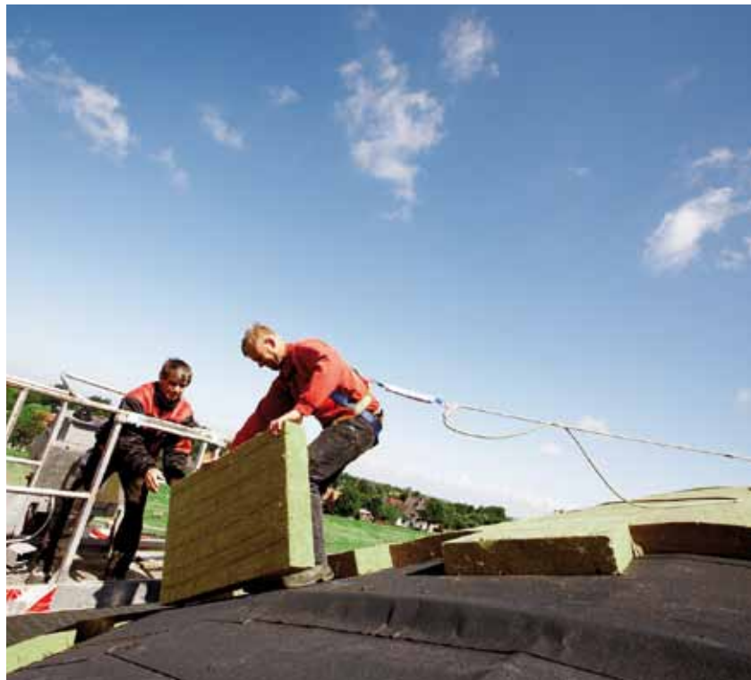
Die Dachform und auffrischende Nordseewinde erforderten teilweise die zusätzliche Leinenabsicherung der Dachdecker.
